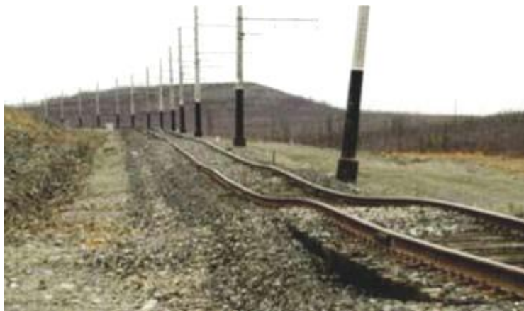
Рис. 6. Участок железнодорожной магистрали, подверженный деформации из-за неравномерной просадки и пучения грунта (фото Д.С. Дроздова) [1]
