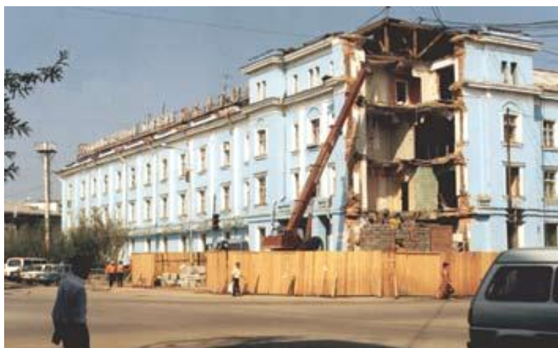
Рис. 5. Обрушение угла здания в центральной части Якутска (фото М.Н. Григорьева, 1999 г.) [1]
