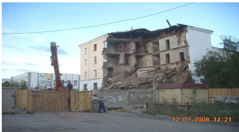
Рис. 4. Обрушение здания из-за разрушения свайных оснований. Якутск (фото С.И. Серикова, 2008 г.) [6]
