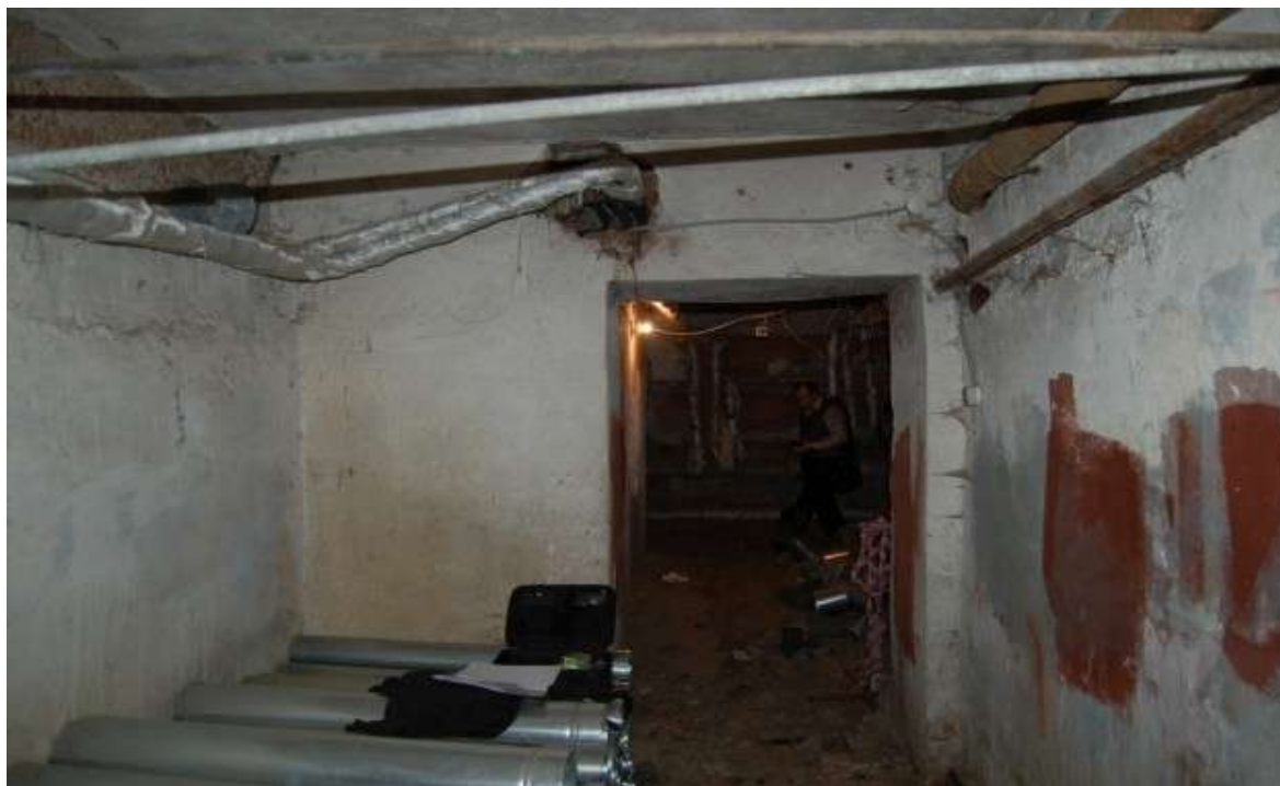
Рис. 3. Увлажнение низа стен из-за отсутствия горизонтальной гидроизоляции фундамента
