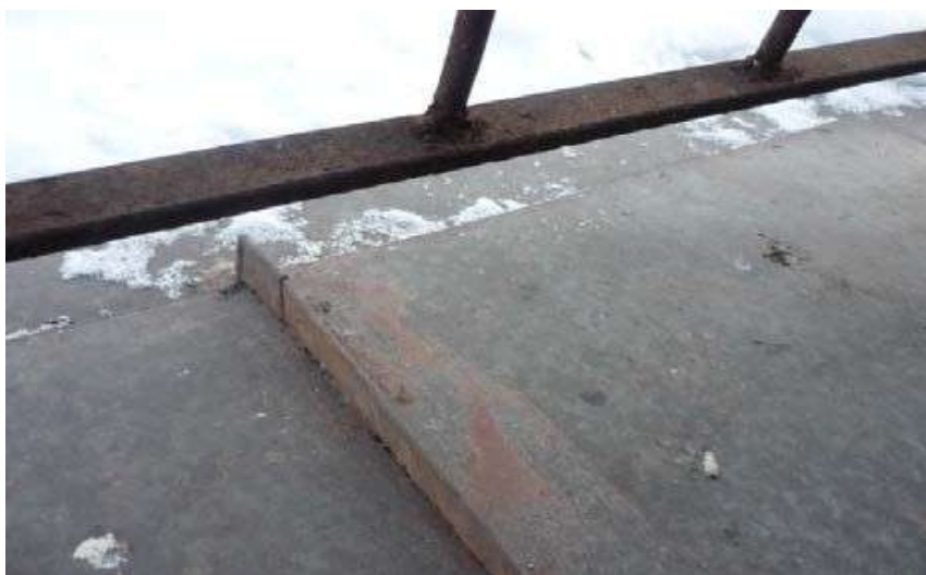
Рис. 5. Физический износ крыши
