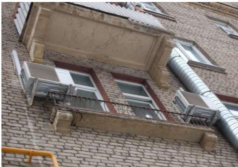
Рис. 4. Физический износ балконов
