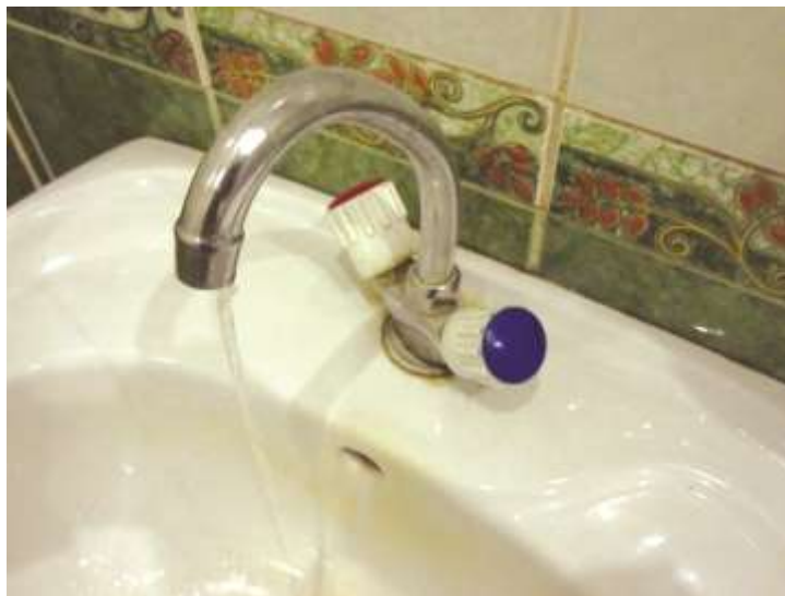
Рис. 1. Двухвентильный смеситель в сантехнической кабине
