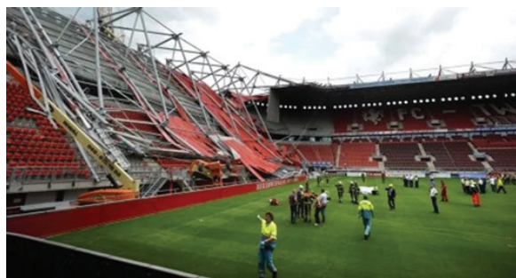
Рис. 3. Обрушение части крыши на стадионе De Grolsch Veste, г. Энсхед, Голландия, 07.07.2011 3
