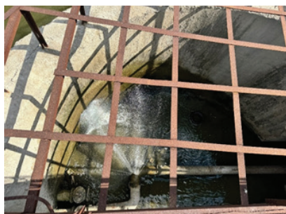
Рис. 7. Прорыв трубы шахтного водосброса на водохранилище Михайловское I
