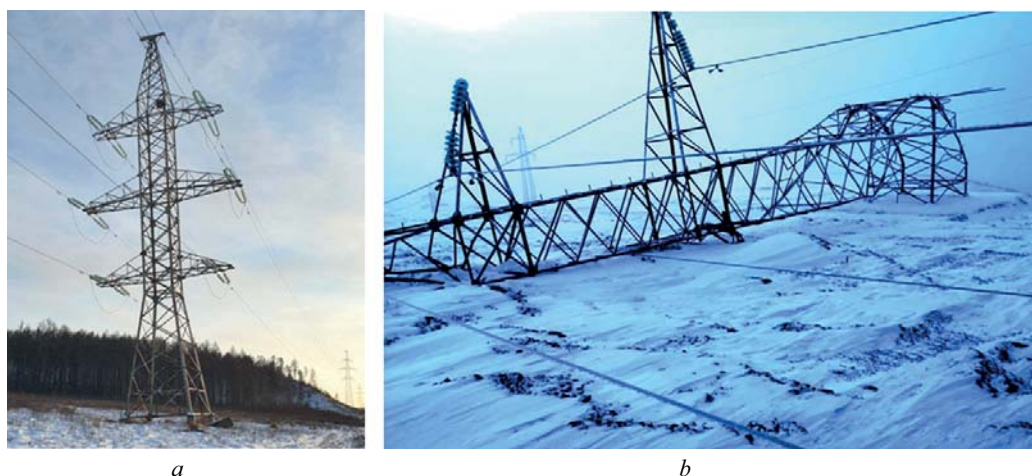
Рис. 2. Примеры повреждения и аварии строительных конструкций ВЛ: a — предаварийный наклон анкерно-угловой опоры У220-1 по причине морозного выпучивания фундаментов из-за нерасчетного промерзания грунтового основания (Забайкалье, 12.2022); b — одна из двух упавших промежуточных одноцепных опор типа 2П220-1-6.8 по причине сверхрасчетных ветровых нагрузок (Иркутская область, 11.2019)
