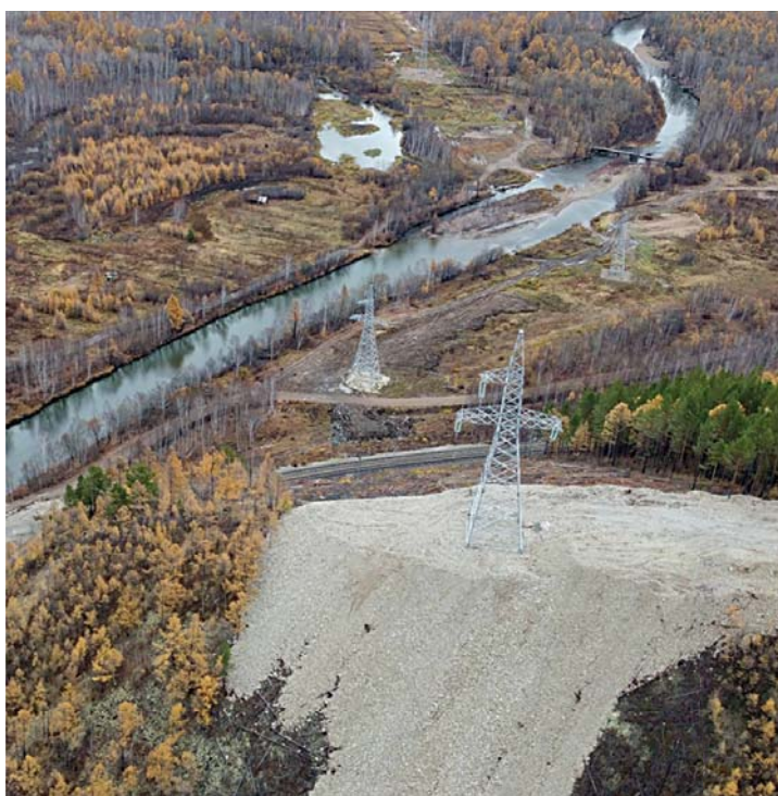
Рис. 1. Спуск одноцепной ВЛ 220 кВ «Могоча – Зилово» с сопки и переход через Транссибирскую магистраль и замерзающую р. Амазар (Забайкалье, 09.2022)
