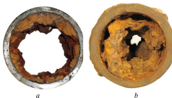
Рис. 1. Фрагмент отложений на внутренней поверхности стальных (а) и чугунных (б) труб
