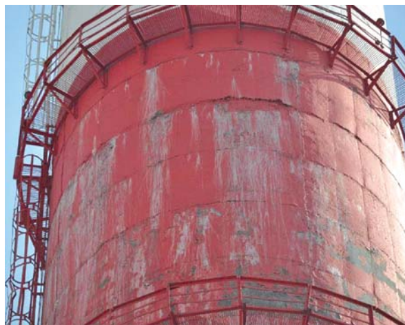
Рис. 4. Процесс выщелачивания свободной извести по ослабленным сечениям бетона
