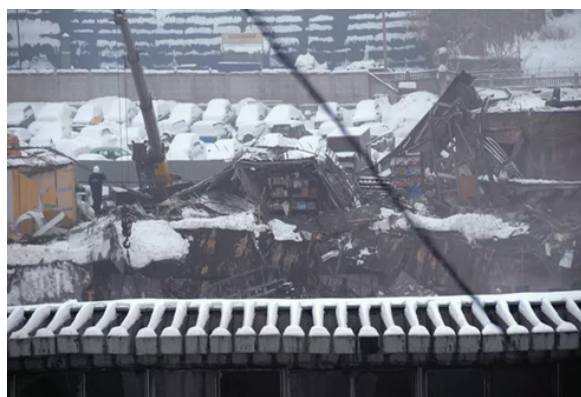
Рис. 2. Обрушение покрытия на рынке ГУП «Басманный», г. Москва, 23.02.2006 2
