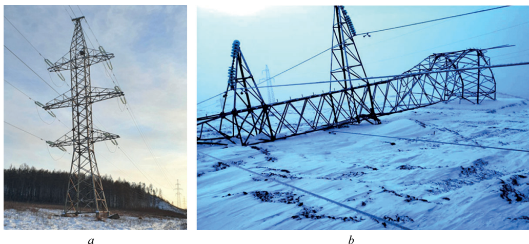
Рис. 2. Примеры повреждения и аварии строительных конструкций ВЛ: a — предаварийный наклон анкерно-угловой опоры У220-1 по причине морозного выпучивания фундаментов из-за нерасчетного промерзания грунтового основания (Забайкалье, 12.2022); b — одна из двух упавших промежуточных одноцепных опор типа 2П220-1-6.8 по причине сверхрасчетных ветровых нагрузок (Иркутская область, 11.2019)
